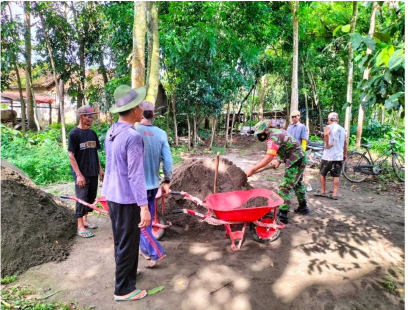
Sertu Wiwit Ariyanto bersama warga Gotong Royong/Kerja Bakti melaksanakan penimbunan jalan yang berlumpur
